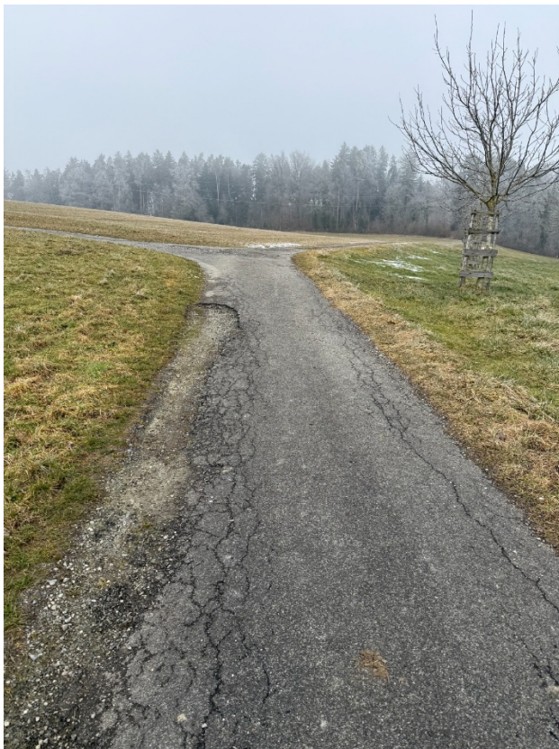
Bild 1: Berghaldenstrasse vor der Sanierung
